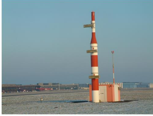
Şekil.5. Dikey Eksendeki Verici (Glide Slope) Anteni
